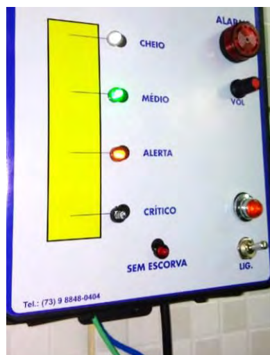
Figura 3 - Módulo controlador (comandos e LEDs) fixado em área externa do reservatório
