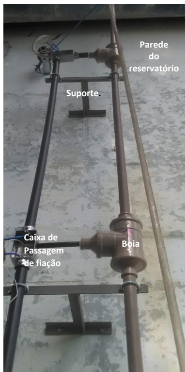
Figura 1 - Detalhe da instalação da boia e dos fios elétricos para conexão com a placa fixados à parede do reservatório em agosto de 2018
