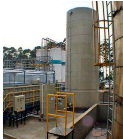
Fig 3. Aeradores Por AR Difuso
