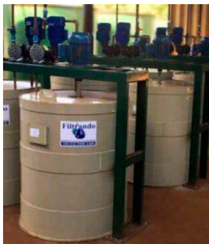
Fig 5 - Unidade de Preparo de solução Química
