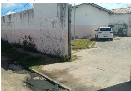
Figura 7: Esgoto na frente de escola.
