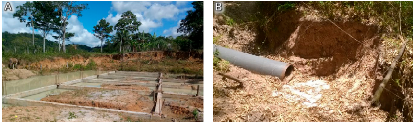
Figura 11 - Registros fotográficos: (A) - Estação Elevatória em construção da Embasa localizada no acesso principal da unidade de conservação; (B) - Tubos da adutora expostos ao longo das trilhas.
