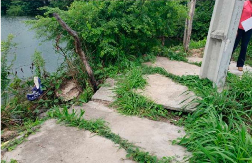
Figura 12 - Estrutura deteriorada do piso da calçada e avanço das gramíneas.
