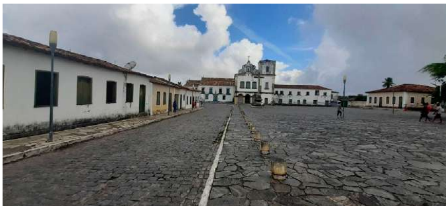
Figura 05 - Calçadas em pedra, com pavimentação quebrada e com obstáculos.
