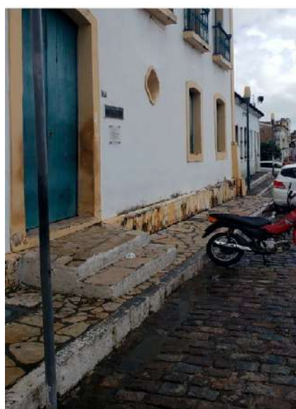
Figura 07 - Ausência de calçadas e falta de acessibilidade na entrada de edificações.
