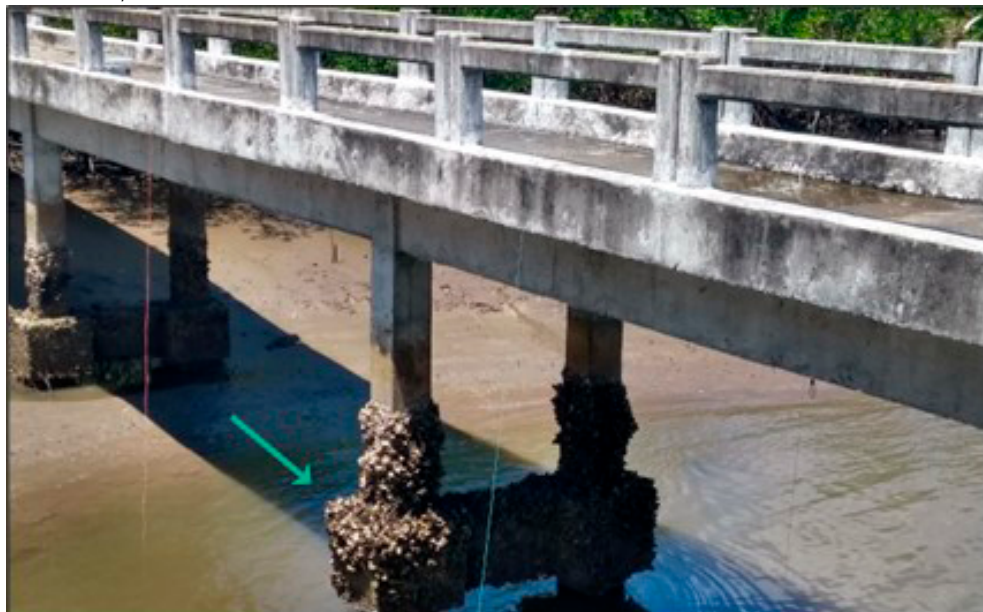
Foto 2: Desgaste da estrutura com a presença de ostras encrustadas na passarela do Porto dos Cavalos em Estância/SE
