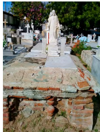
Figura 14 – Desgaste em túmulo
