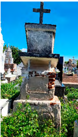
Figura 13 – Desgaste em túmulo
